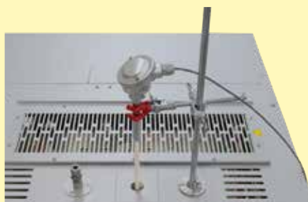
Passaggio per termocoppia nel cielo con cavalletto
