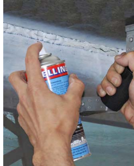
Schweißnahtprüfung auf einer Brücke mit einer schwarzen Magnetpulversuspension und weißer Untergrundfarbe NR 104
